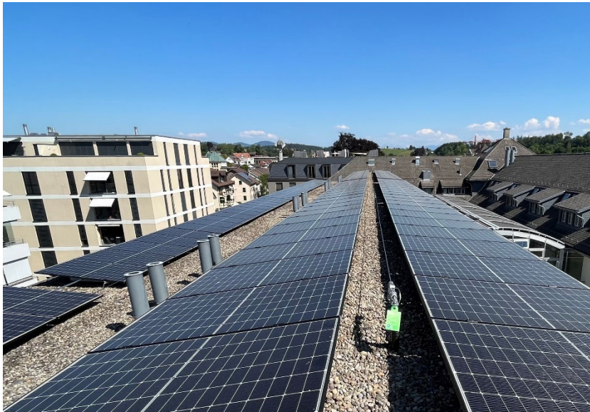
Dach Neubautrakt, Photovoltaikanlage mit 51 kWp Leistung
