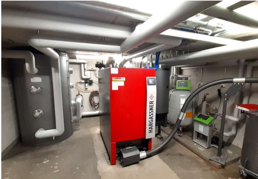
Heizzentrale mit Pellet-Heizkessel
